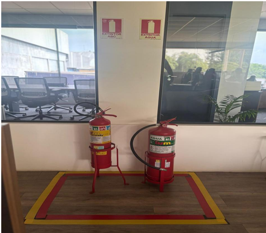
Figura 2 - Extintores de incêndio instalados em área interna da empresa
